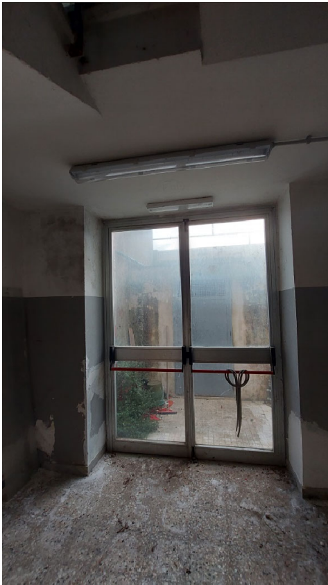
Foto 14 Infissi al piano seminterrato da sostituire
