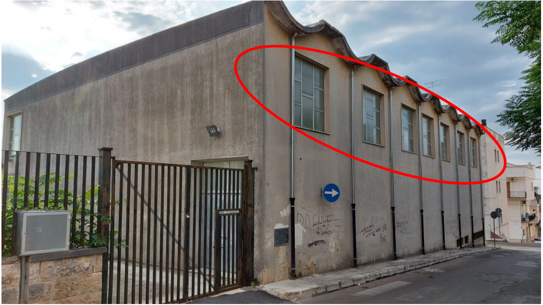
Foto 25 Infissi da sostituire
