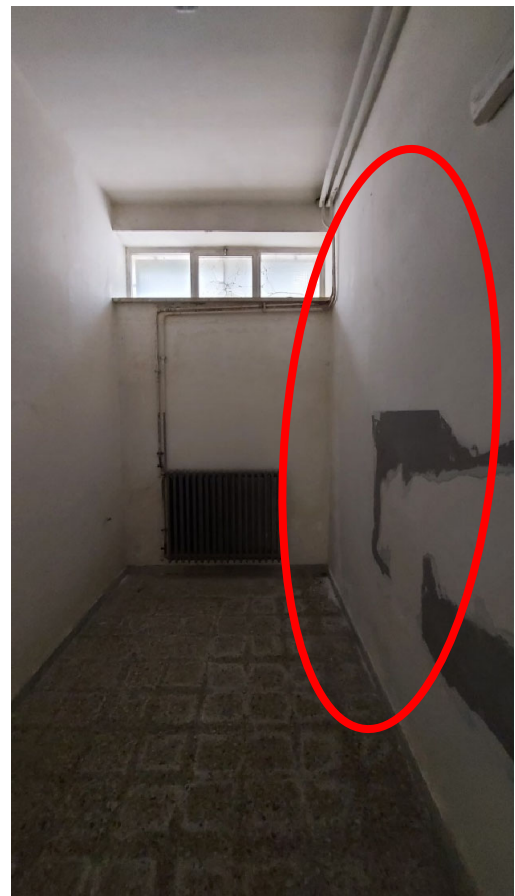
Foto 17 Infissi da sostituire p.int
