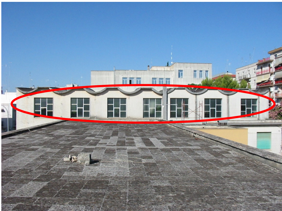
Foto 4 Prospetto interno oggetto di intervento di ripristino rivestimento a seguito realizzazione nuova muratura e solaio di copertura.
