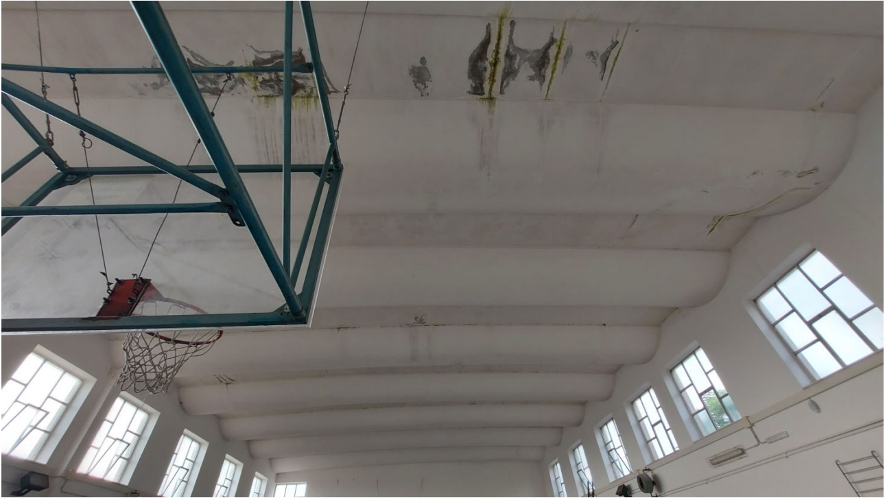
Foto 9 Infiltrazione dal solaio
