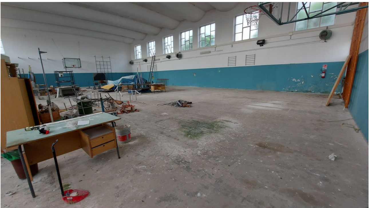
Foto 8 Interno palestra pavimento umidità sia di risalita per infiltrazione dalla strada che da quella proveniente dal solaio di copertura.
