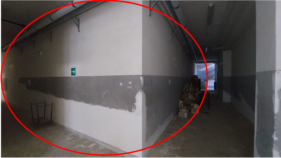
Foto 27 Parete in cemento da stonacare ripristinare il cemento e rintonacare
