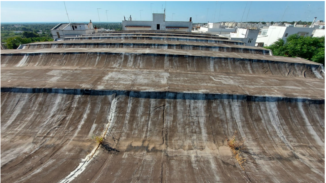
Foto 10 Copertura guaina da rimuovere
