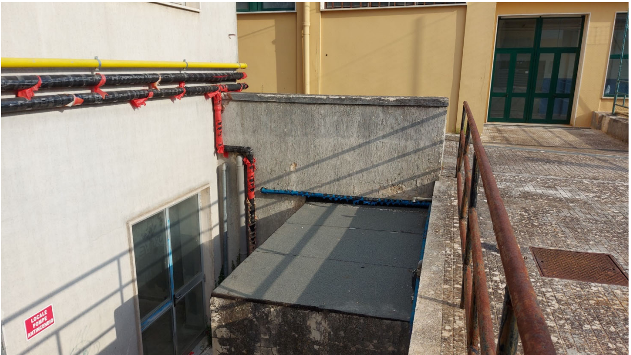
Foto 5 Copertura del Solaio della centrale idrica da rifare. Coibentazione delle tubazioni con lamierino.
