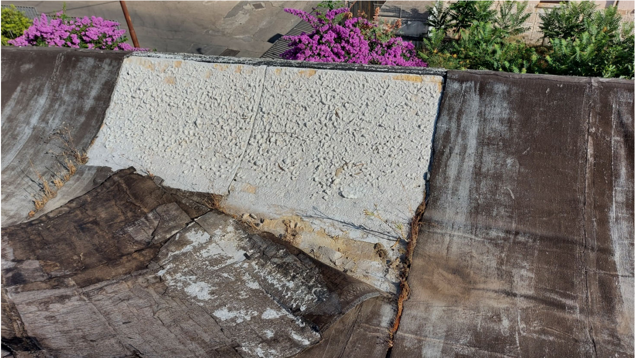
Foto 11 Copertura particolare dell'isolante posto sotto alla guaina da rimuovere.
