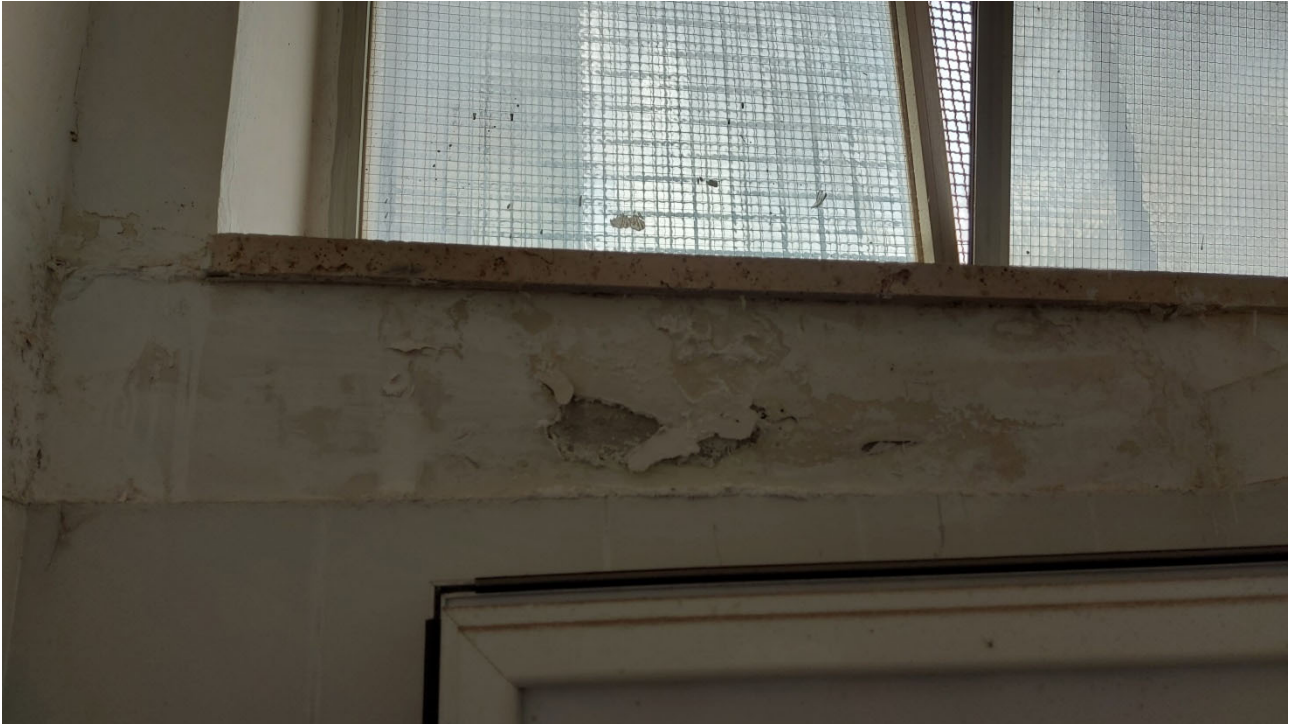
Foto 19 Piano Interrato, infiltrazione dovuto alla mancanza di tenuta degli infissi da sostituire. Intonaco da ripristinare.
