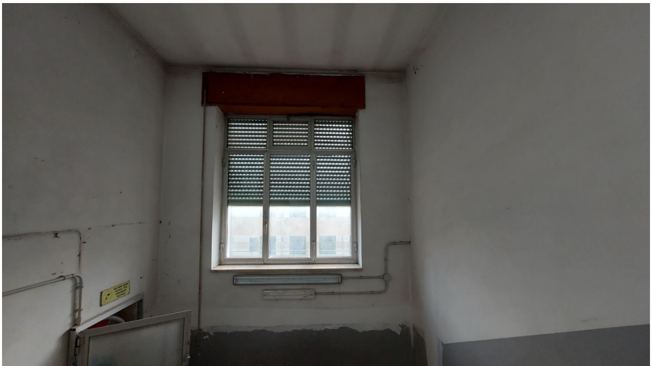
Foto 20 Vano scala infisso con cassonetto da rimuovere e sostituire. Gli avvolgibili non verranno più rimessi.
