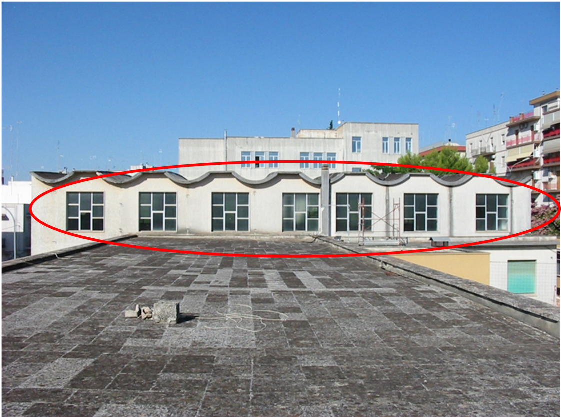
Foto 26 Infissi da sostituire
