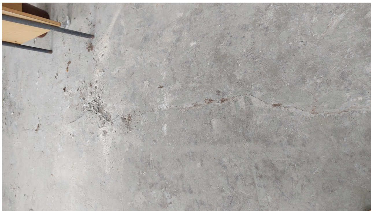
Foto 24 Particolare pavimento palestra punto di congiunzione tra vespaio e solaio del piano interrato che dovrà essere ripristinato previa rimozione del sottofondo.
