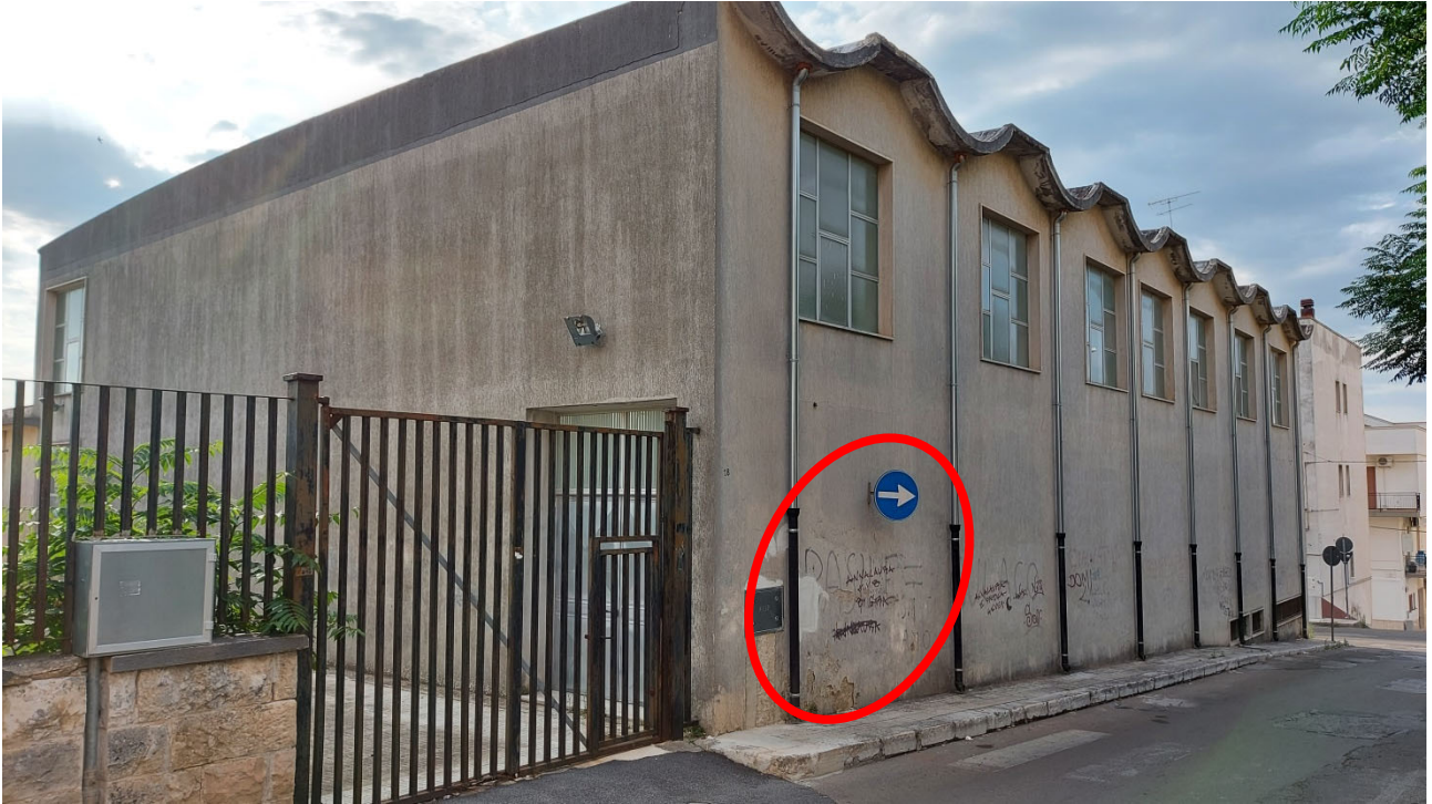
Foto 1 Lato Ingresso. Parete oggetto di rimozione e rifacimento degli intonaci. Via Sant' Antonio Abate. In rosso evidenziato la muratura di tamponamento da rimuovere e realizzare
